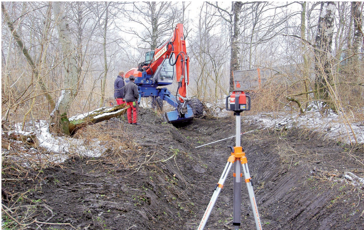
Bei der Ausführung der Arbeiten: Weil das Gefälle in der Rheinebene gering ist, musste die Aushubhöhe exakt erfolgen, damit das Wasser künftig wieder fließen kann.
